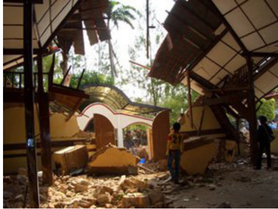
Gambar 2.2; Bangunan Gereja HKTY, Ganjuran setelah gempa 2006
