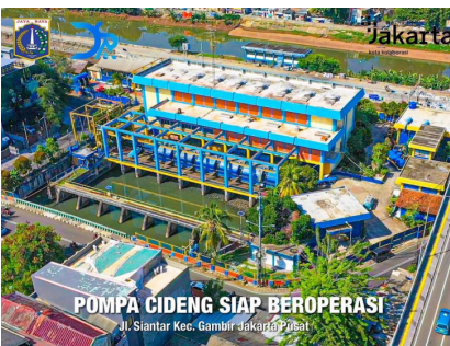
Sumber: megapolitan.okezone.com Stasiun pompa Cideng
